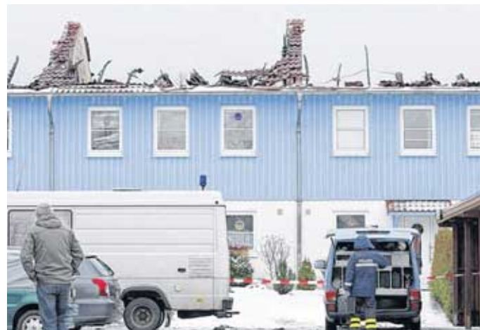
Die vier Reihenhäuser waren nach dem Brand nicht mehr bewohnbar. Fotos (2): Jakob Richter
