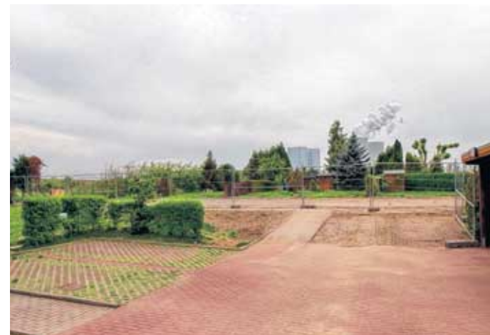
Die ruinösen Brandhäuser wurden seit März abgerissen. Im Juni soll der Neubau beginnen.
