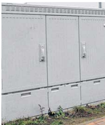
Die nötige Technik steckt in einem unscheinbaren Kasten.
