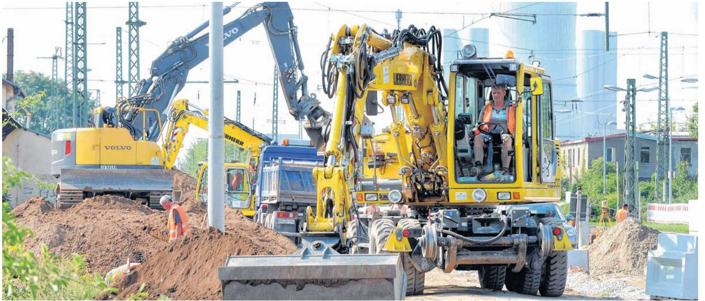
Die Bauarbeiten für das neue Gleisbett im Böhlener Bahnhof laufen auf Hochtouren. Zukünftig sollen dort ICE-Züge mit höherer Geschwindigkeit den Bereich befahren können.
